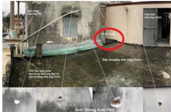
Hình (II) vị trí hố KT trên sân thượng nhà ông Chức
