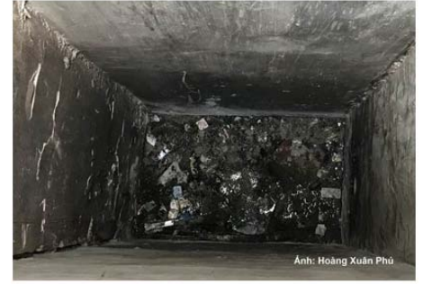
Hình VII, những vết cháy nám và dạn nứt ở thành đáy hố KT
